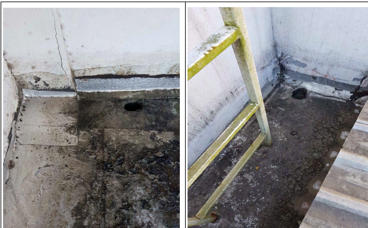
Foto 01 – Exibe dois trechos da laje de cobertura onde não houve instalação dos ralos hemisféricos na parte superior dos coletores de água pluvial.
