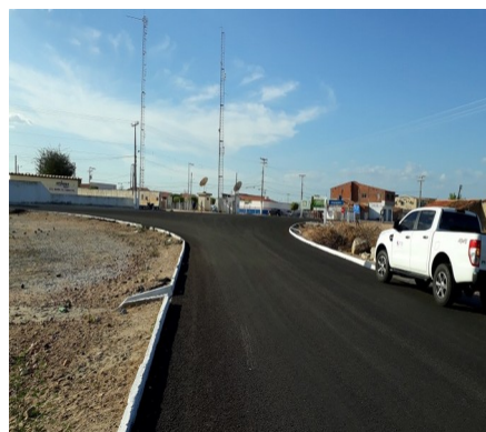
Foto 5 - Ausência de sinalização
