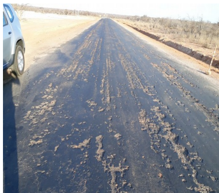
Foto 3 - Irregularidade no pavimento
