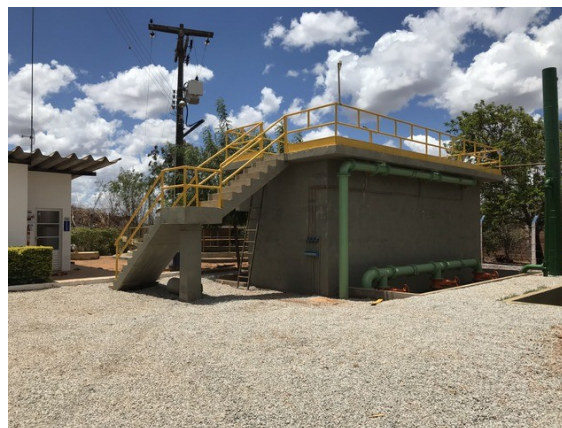
Foto 4 – Filtro da Estação de Tratamento de Água
