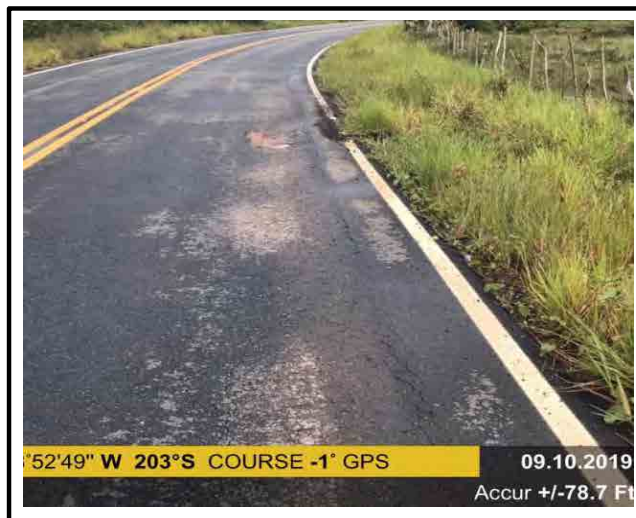
BA 420 problemas identificados no pavimento
